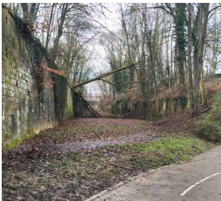
Les arbres malades ou fragilisés seront supprimés pour éviter les chutes
