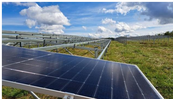
Parc photovoltaïque de Fontaine
