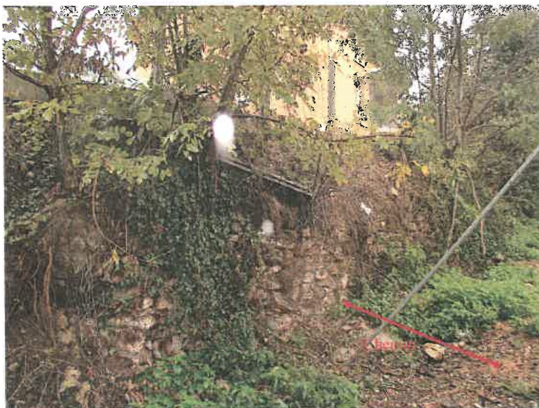
3 - Mur de soutènement de la copropriété du 10 rue des Perches, le long du chemin
