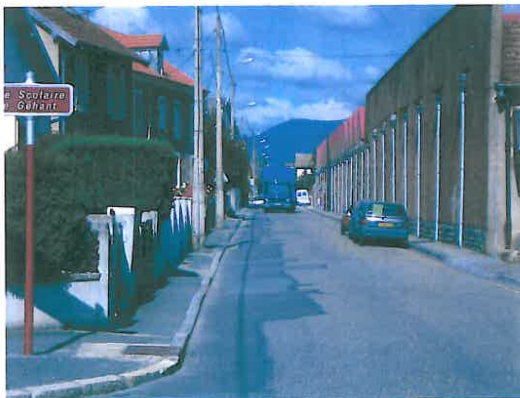
Vue de la rue du Salbert avec les deux trottoirs non conformes
