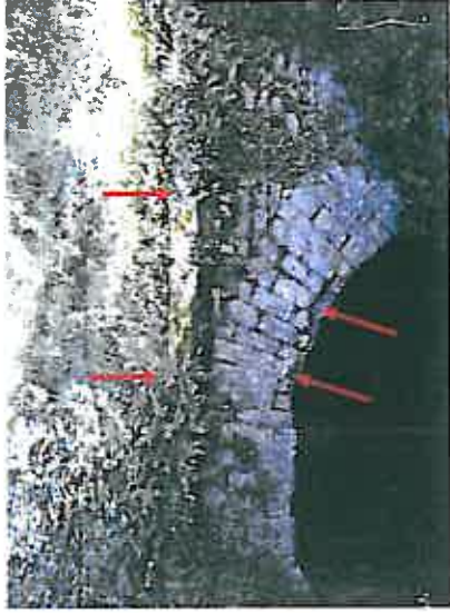
45. Vue de la casemate du fossé de l'enceinte intermédiaire: désorganisation de la maçonnerie et des couvertines, envahissement par la végétation, joints largement ouverts menace de chute de pierres.
