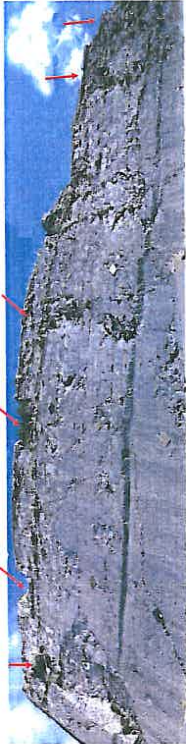
41. Vue du mur du belvédère depuis le rempart extérieur ou Sud : développement de la végétation et des micro-végétaux, désorganisation des pierres de couvertines et des maçonneries de l'éperon.
