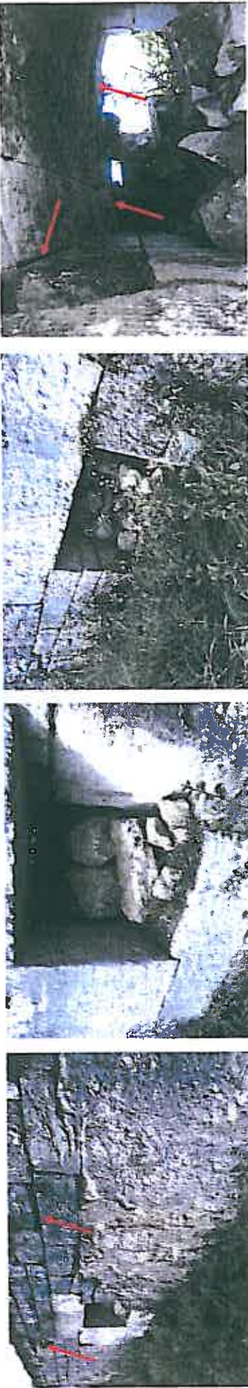
33 à 34. Vue en détail du mur de contrescarpe depuis le belvédère Sud : altération des pierres, fissuration et joints ouverts. Obturation des bouches-à-feu par gravats de pierre, désorganisation des maçonneries, joints ouverts.
