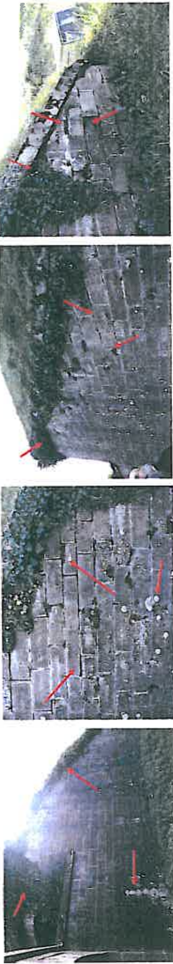
11 à 14. Mur du bastion coté contrescarpe Sud situé à l'ouest de la touraille: altération des pierres de couverture, présence de végétation et recouvrement de l'arase, joints ouverts, présence de micro-végétaux et de salissures en élévation
