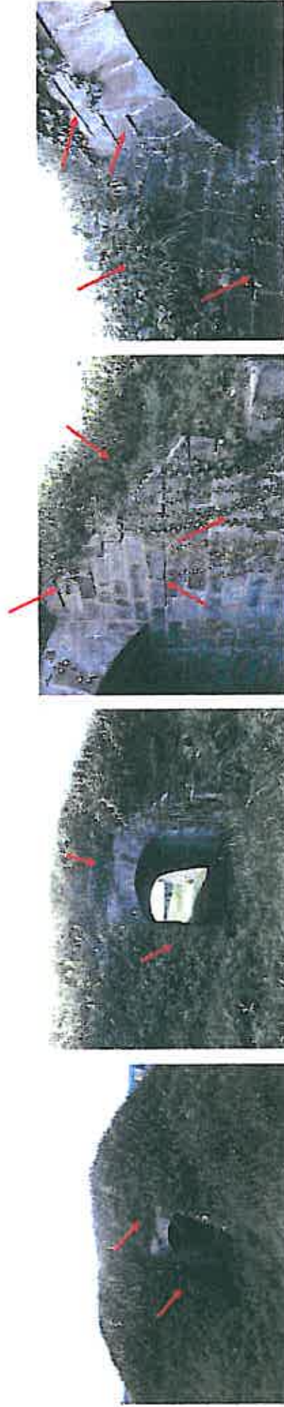
22 à 25, Elevation Est de la traverse centrale, désorganisation et glissement du talus, développement de la végétation, recouvrement des pierres de couverture, joints ouverts.
