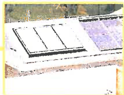
Panneaux solaires thermiques et photovoltaïques
